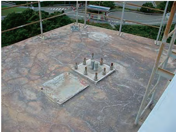
写真-6 コンクリート劣化状況 (HVa15P) Concrete deterioration (HVa15P)
