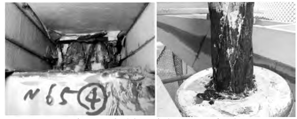
写真-1 定着部の腐食状況(大鳴門橋)
