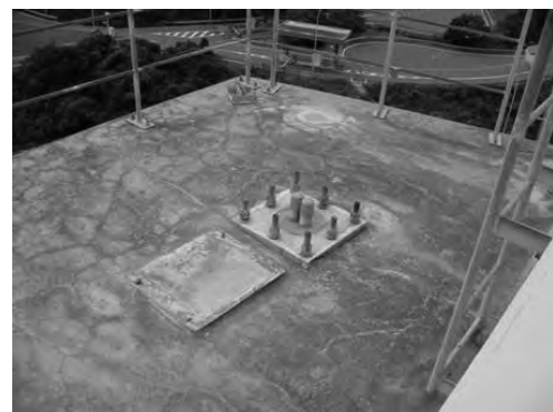
写真-1 コンクリート劣化状況 (HVa15P)
