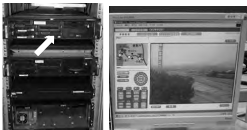
写真-3 監視制御装置 Photo 3 Monitoring Control Unit
