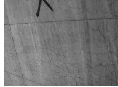
(c)亀甲状のひび割れ
