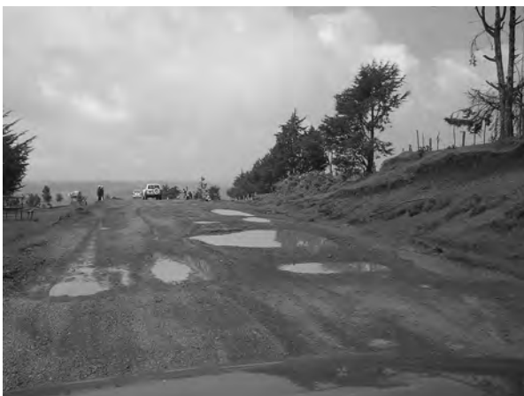
写真一2 損傷した道路 Photo 2 Damaged Road
