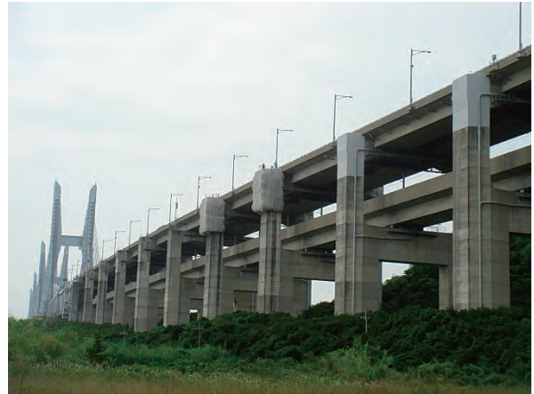
写真-7 櫃石島高架橋の ASR 対策状況 ASR measures of Hitsuishijima viaduct
