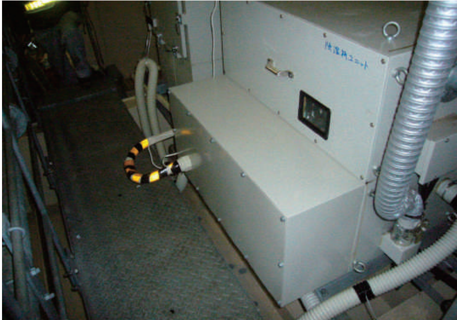
写真-1 プレクーリング設備の追加設置 Extension of the Pre-cooling Facility
