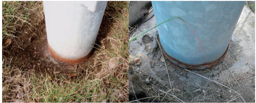
写真-2 照明柱基部腐食状況例
