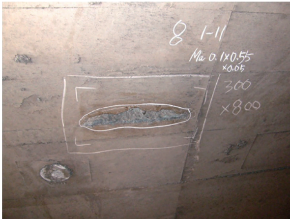
写真-5 覆工コンクリート打設孔跡付近の変状 Photo.5 Defects around the concrete placing hole on concrete lining
