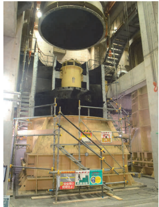
写真-4 上り線排風機の構造 Vertical type exhaust fan
