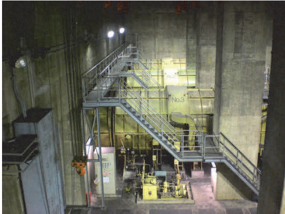
写真-1 下り線換気所の排風機外観 Kudarisen ventilating station
