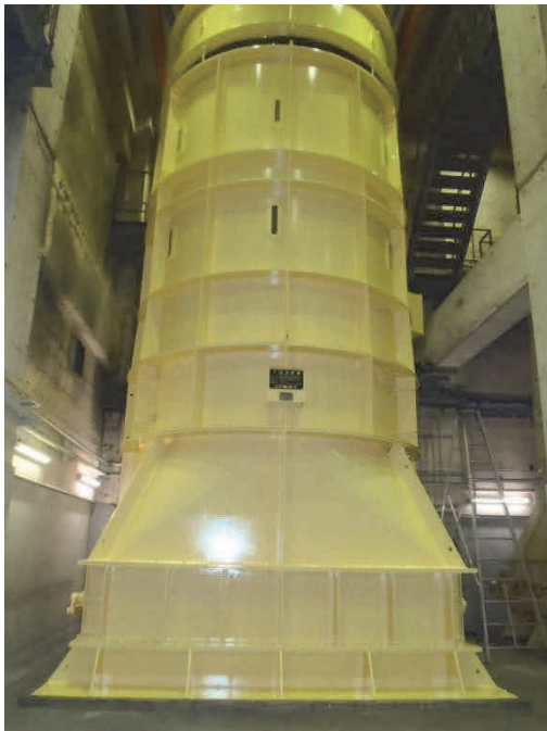
写真-3 上り線換気所の排風機外観 Noborisen ventilating station
