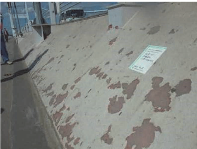
写真-11 補剛桁上面塗装の損傷
