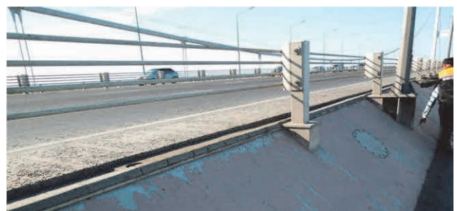
写真-13 防護柵ケーブルのたるみ
