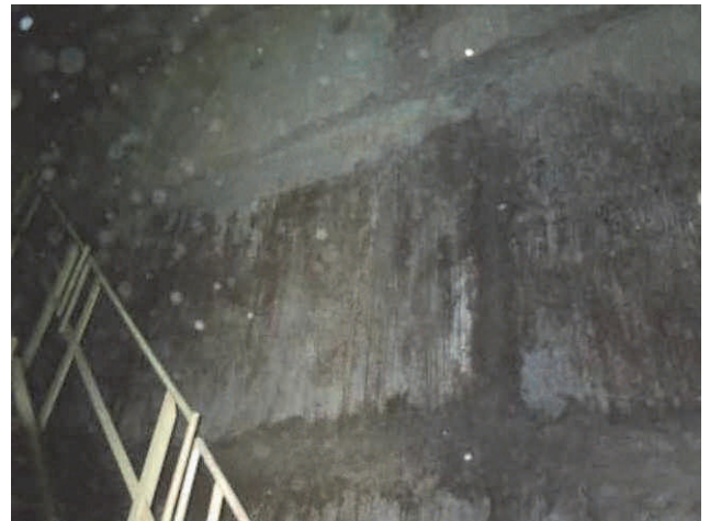
写真-8 アンカレイジ内結露 Photo 8 Dew Condensation in Anchorage
