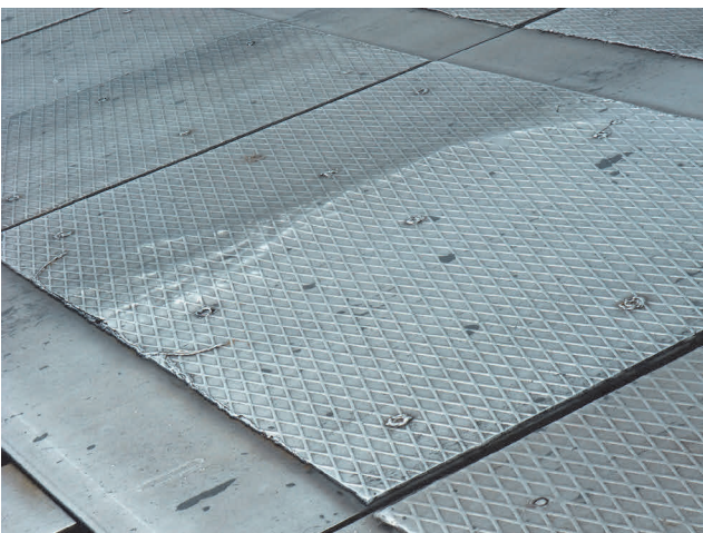
写真-12 伸縮装置の損傷
