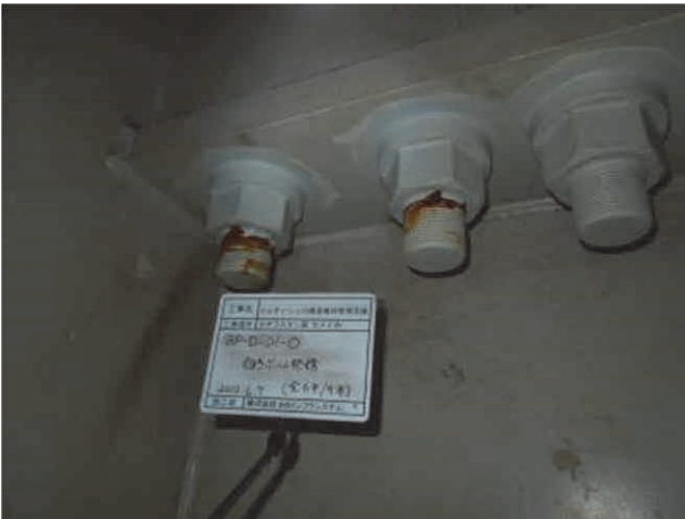
写真-10 主塔長尺ボルトの発せい
