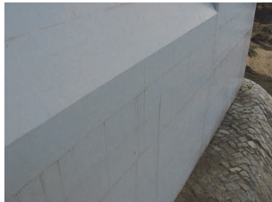
写真-5 エポキシ樹脂塗膜の割れ Photo 5 Crack on Epoxy Resin Coating
