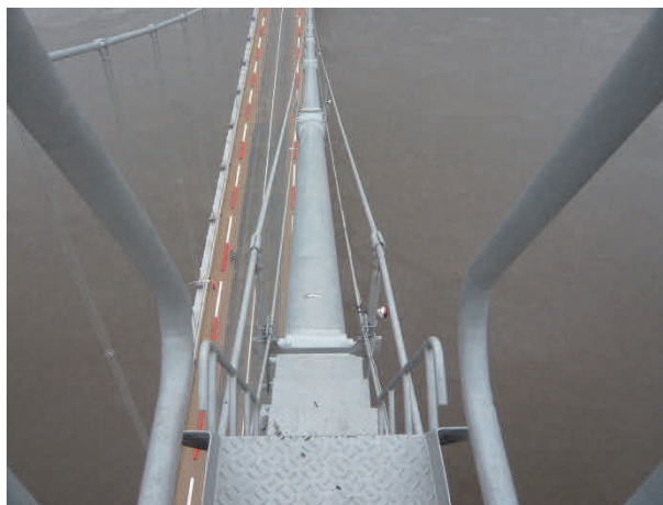
写真-6 主ケーブル Photo 6 Main Cable
