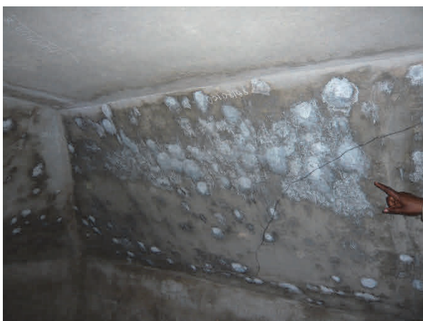
写真-8 アンカレイジ上屋内の漏水 (遊離石灰)
