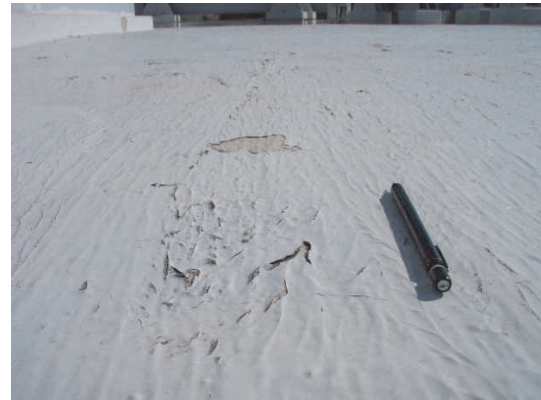
写真-3 アクリルゴム塗膜上塗りのはがれ Photo 3 Peeling of Top Coat of Acrylic Rubber Coating
