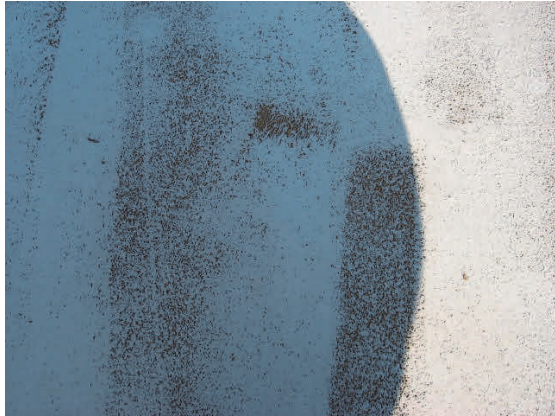
写真-7 ポリウレア系塗膜の劣化 Photo 7 Deterioration of Polyurea Coating
