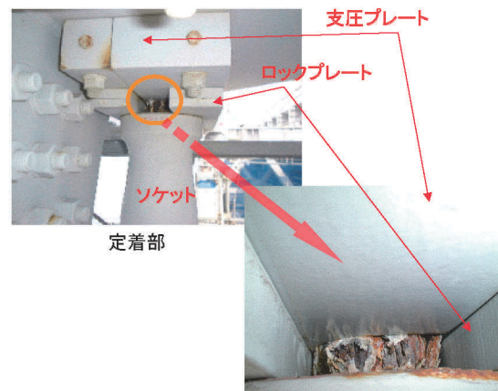
写真-2 ロープ定着部の腐食状況 (大鳴門橋)
