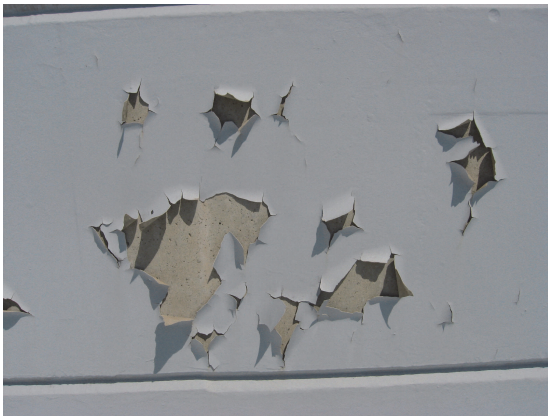
写真-8 はがれの顕在化した塗膜 Photo 8 Severely Peeled Coating
