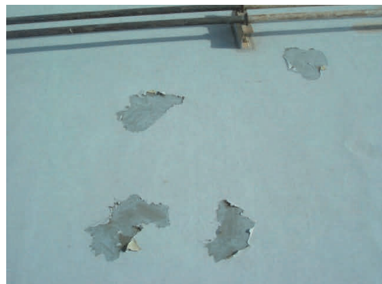
写真-6 超速硬化型ポリウレタン上塗りののがれ Photo 6 Peeling of Top Coat of Ultrarapid Hardening Polyurethane
