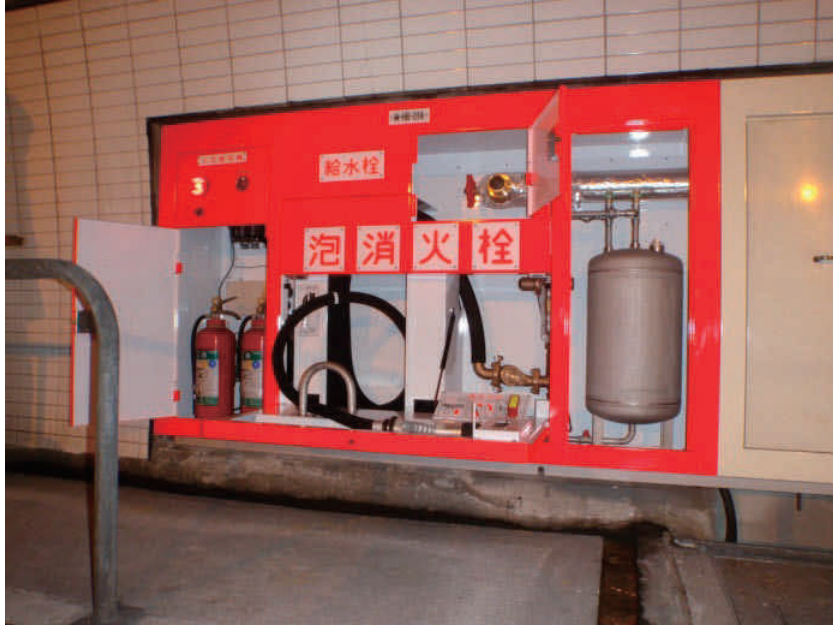
写真-3 舞子トンネル泡消火栓
