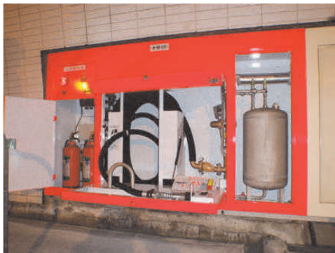
写真-6 泡消火栓（更新後） Photo 6 Foam fire hydrant (after update)
