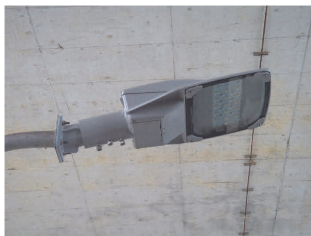
LED照明器具 (更新後)
