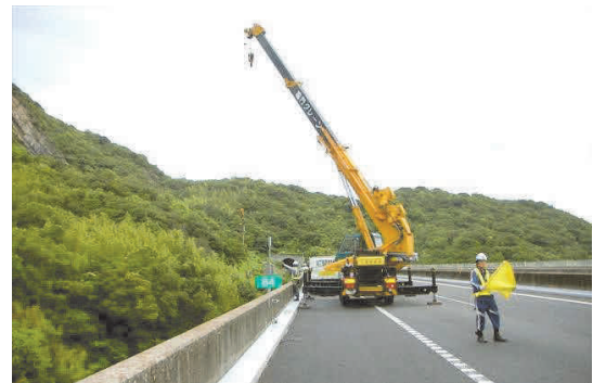
写真-6 高速道路本線からの部材搬入 Photo 6 Retrofitting materials unloaded from bridge deck
