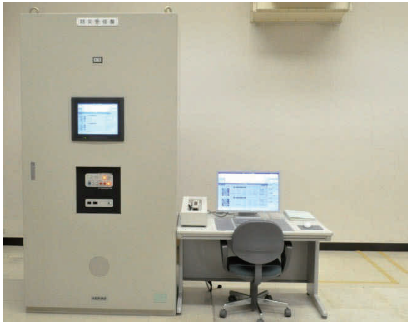
写真-4 舞子トンネル防災受信盤
