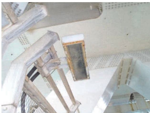
蛍光灯照明器具 (更新前)
