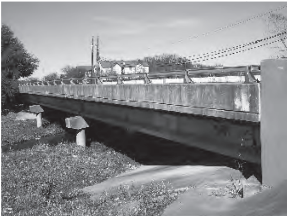
写真-4 実習対象のプレストレストコンクリート橋 Photo 4 Prestressed Concrete Bridge for Field Study
