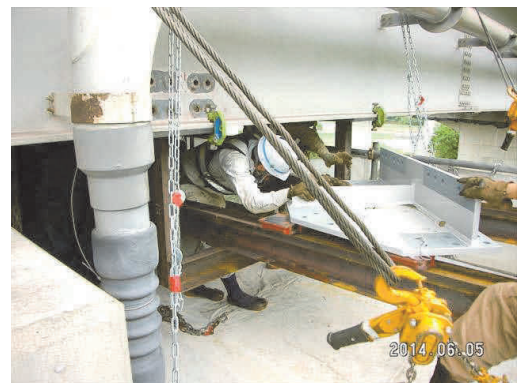
写真-7 搬入した部材の横移動 Photo 7 Horizontal material handling using H-shaped beams
