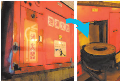
写真-5 泡消火栓（更新前） Photo 5 Foam fire hydrant (before update)
