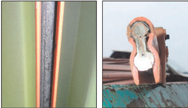
写真-4 絶縁トロリー線の導体の表面劣化 Photo 4 Damage of the trolley wire surface
