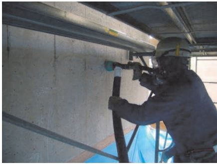
写真-9 バキュームブラストによる下地処理 Photo.9 Surface preparation by vacuum blast
