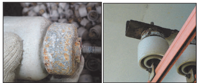
写真-6 絶縁碍子キャップ及び支持金具の腐食
