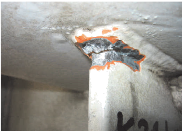
写真-1 垂直補剛材の亀裂の例 (岩黒島橋 格点24 上り線 G2縦桁 中央分離帯側) Photo.1 Crack in vertical stiffener(example)
