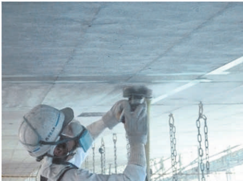
写真-10 ディスクサンダーによる下地処理 Photo.10 Surface preparation by disk sander
