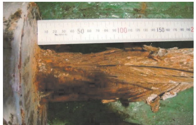
写真-6 ハンガーロープ破断状況（上り線格点 87）
