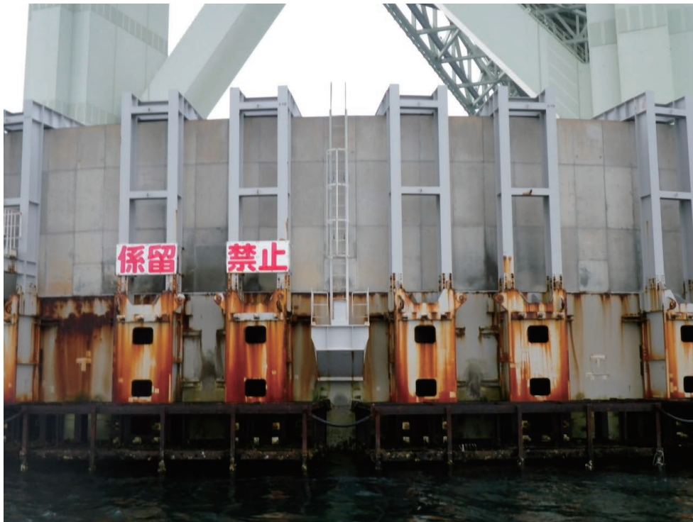
写真-3 2P 海上部調査（鋼ケーソン外板及び船舶緩衝工に腐食が見られる）
