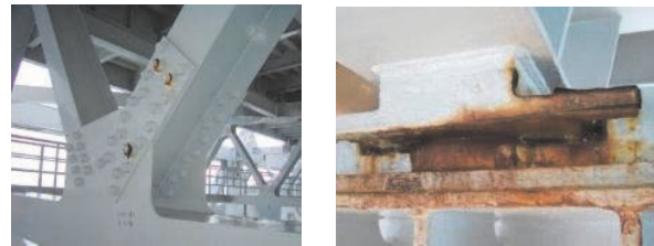
写真-15 局部腐食状況
