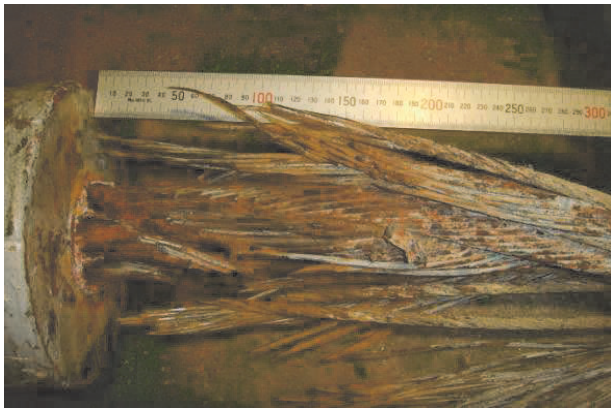
写真-7 ハンガーロープ破断状況（下り線格点90） Photo 7 Broken state of suspender rope (No.90 Down line)
