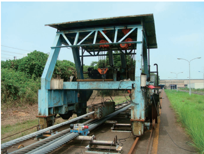
写真-6 全磁束法によるハンガーロープ一般部の 腐食状況調査
