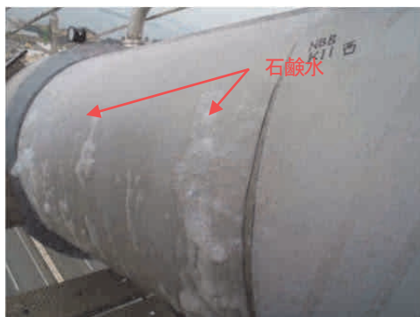
写真-6 ケーブルからの漏洩箇所
