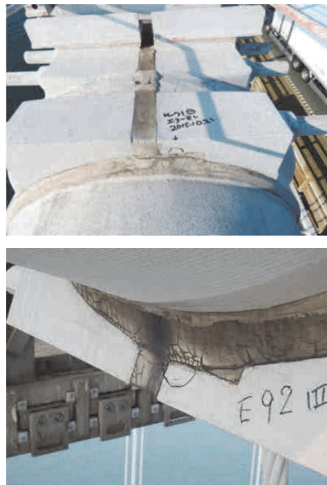
写真-5 ケーブルバンドシール部の劣化状況 Photo 5 Deterioration at Cable Band Sealing
