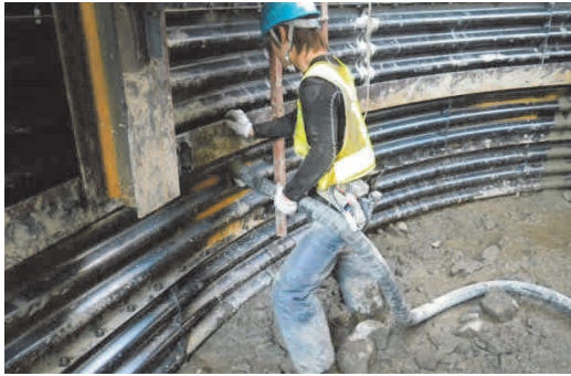
写真-6 ライナープレート周辺へのモルタル注入 Photo 6 Mortar injection behind liner plate
