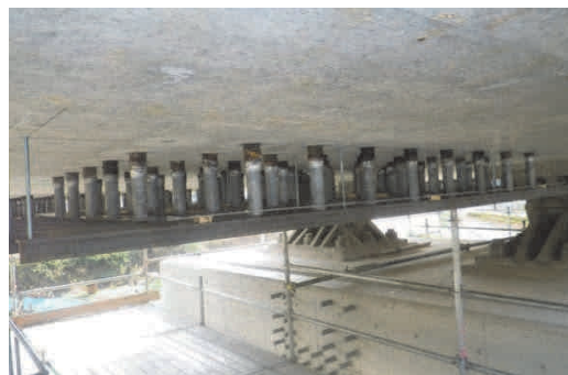
写真-15 アンカーボルト設置時の鋼製テンプレート Photo 15 Steel template for anchor bolts
