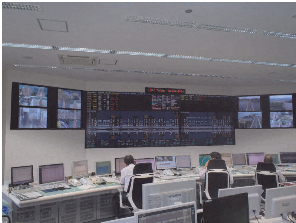
写真-2 岡山管理センター新交通管制室
