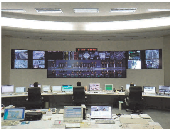
写真-1 神戸管理センター新交通管制室
