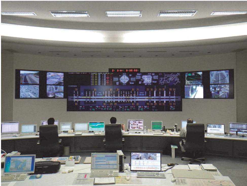
写真-1 神戸管理センター新交通管制室
