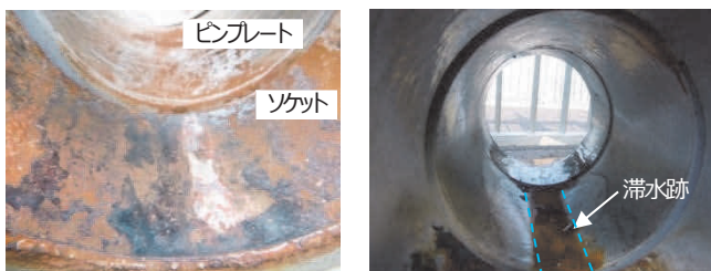
写真-7 ピンプレート内部状況 Photo 7 Condition of pin hole of pin plate
