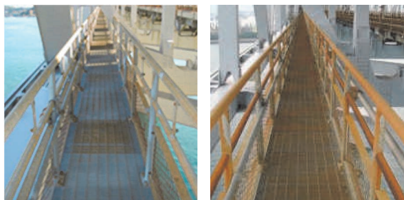
写真-1 写真見本(左：劣化度Ⅲ、右：劣化度Ⅳ)
