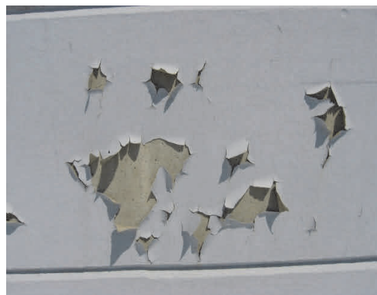
写真-3 ふくれからはがれに進行した表面被覆
