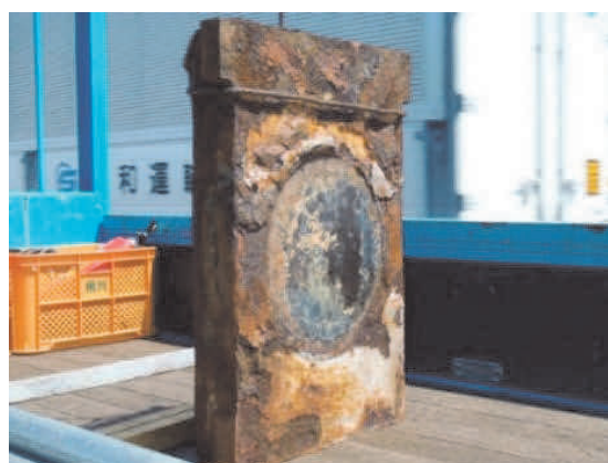
写真-5 上沓のベアリングプレート 当たり面周囲の腐食状況 Photo 5 Corrosion of top bearing around the contact surface with bearing plate
