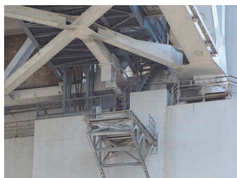
写真-6 制震ダンパー（番の州高架橋トラス部） Photo 6 Viscous Damper
