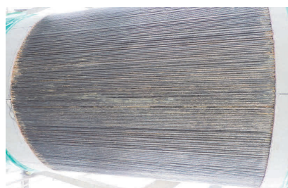
写真-14 ペースト除去後の主ケーブル表面（ケーブル下面）
