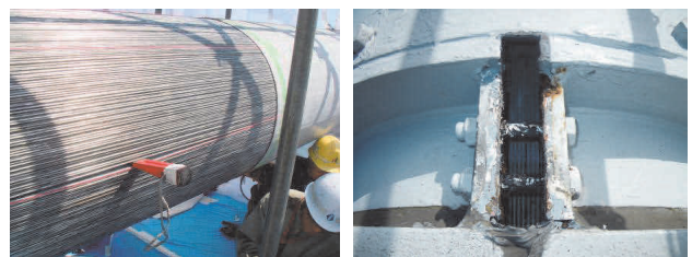
写真-8 開放時の主ケーブル状況 写真-9 バンド部の状況 14)
