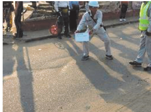
写真-7 平坦性の低下 Photo 7 Decrease of flatness
