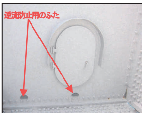
写真-17 水抜き穴の対策
