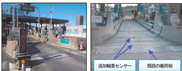
写真-4 入口料金所の高速度対応型軸重計設備
