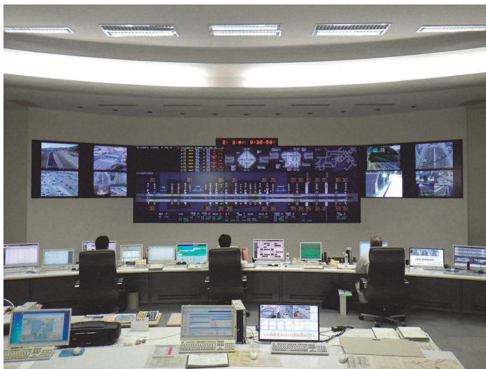
写真-8 神戸管理センター新交通管制室
