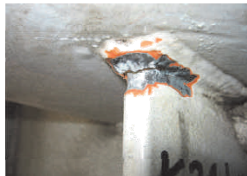
写真-5 垂直補剛材溶接部の亀裂 Photo 5 Crack in vertical stiffener
