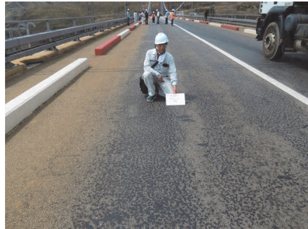
写真-2 表層アスファルトの劣化 Photo 2 Degradation of surface layer asphalt
