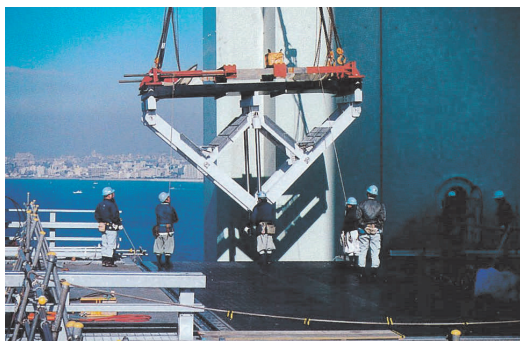
図-9 リンク型伸縮装置（明石海峡大橋）
