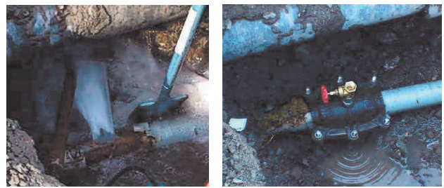
写真-6 給水管の漏水状況と補修の事例(緑PA)
