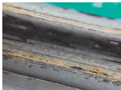
写真-15 クサビ打込後の内部素線状況
