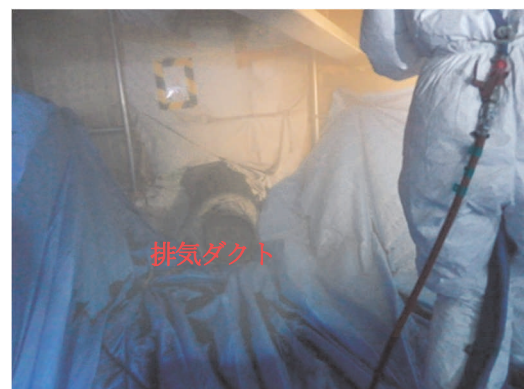
写真-7 排気ダクト (足場内)
