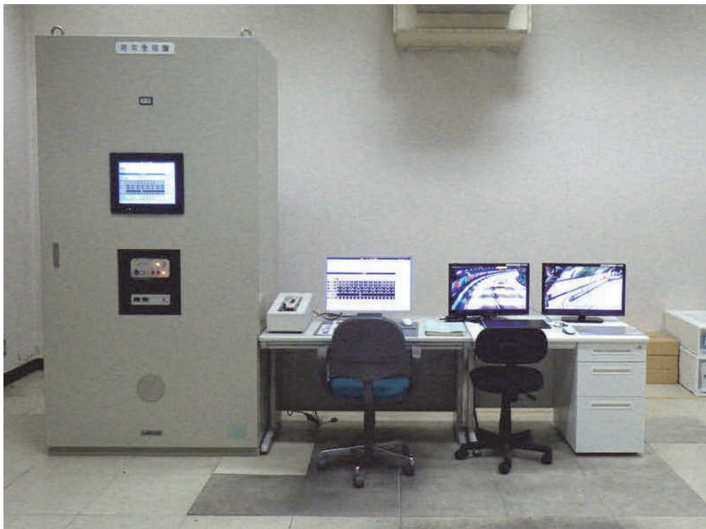
写真－8 舞子トンネルの防災受信盤
