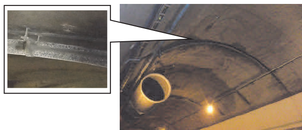
写真－6 舞子トンネル水噴霧配管の腐食状況 Photo 6 Corrosion situation of tunnel water spray pipe
