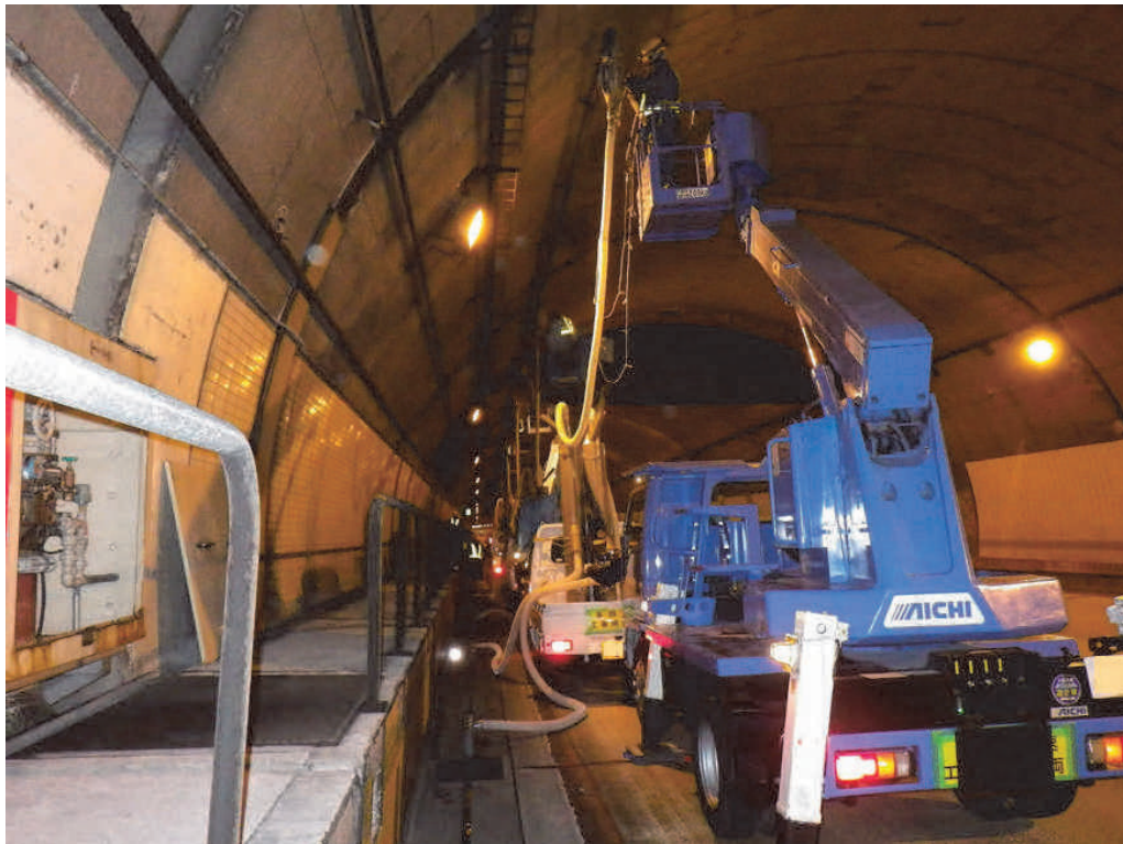
写真－7 水噴霧放水量測定装置
