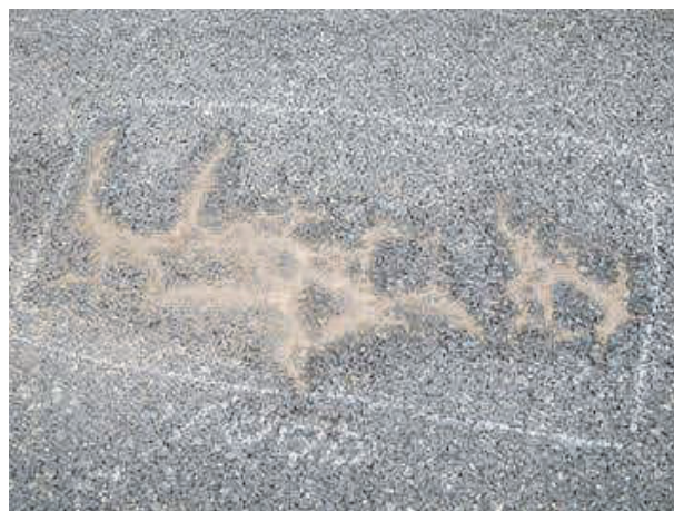
写真-3 路面の噴出物 Photo 3 Ejecta of road surface
