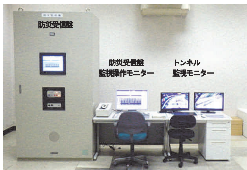
写真－3 改修後の防災受信盤 Photo 3 Disaster prevention control panels(new system)
