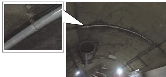
写真-8 更新後の舞子トンネル水噴霧配管(SUS) Photo 8 Tunnel water spray pipe after renewal(SUS)
