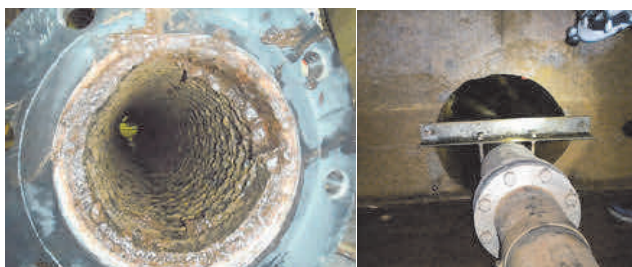
写真－15 排水管内のスケール等の付着と排水管のさや管 Photo 15 Scale in the drainage pipe and sheath pipe of the drainage pipe
