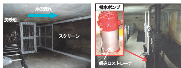
写真-14 沈砂池・スクリーン・排水槽・排水ポンプ
