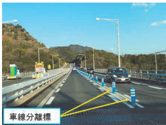
写真－7 対面通行区間車線分離標 Photo 7 Temporary dividing post
