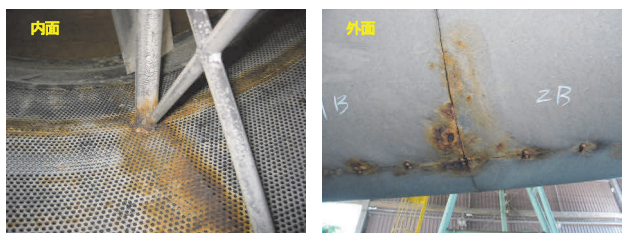
写真-12 ジェットファンの内外面の腐食状況
