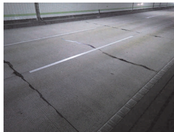
写真-1 トンネルコンクリート舗装目地部の変状 Photo 1 Defects of Concrete pavement(Tunnel)
