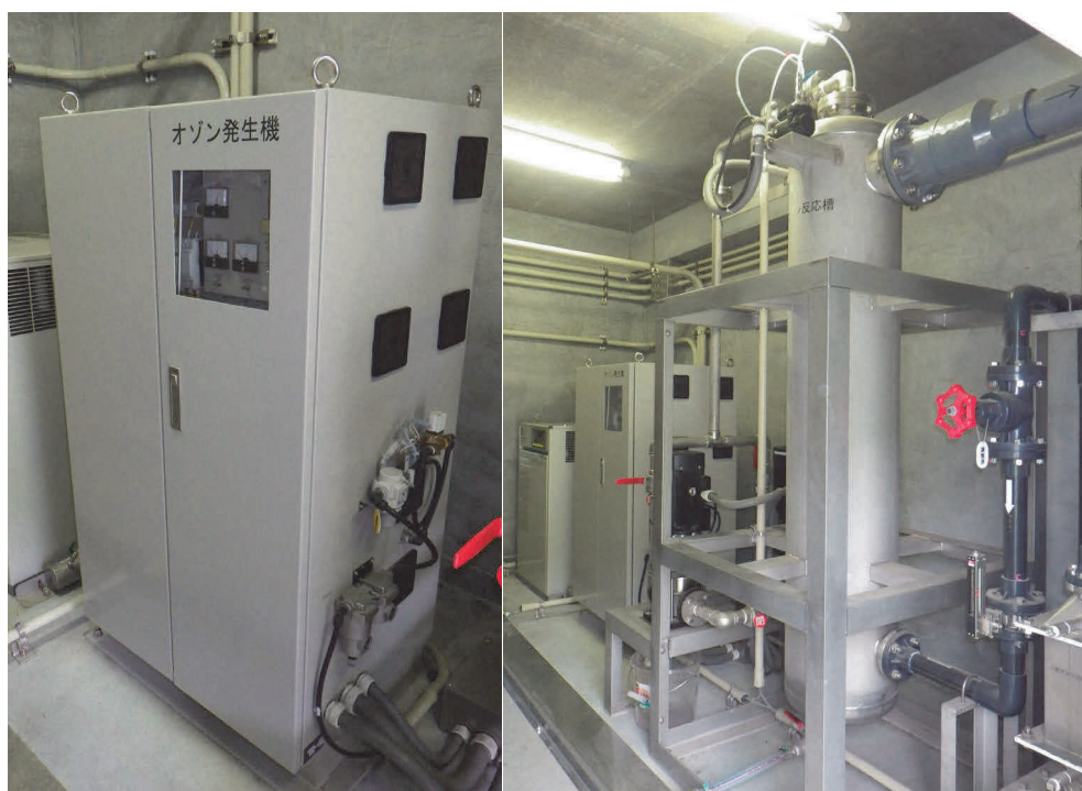
写真－4 オゾン処理装置
