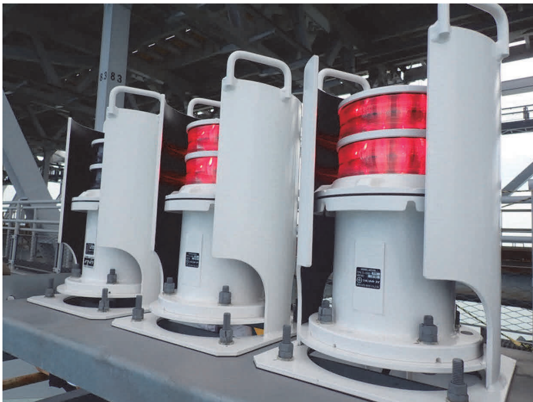
写真－6 南備讃瀬戸大橋橋梁灯（R二灯）
