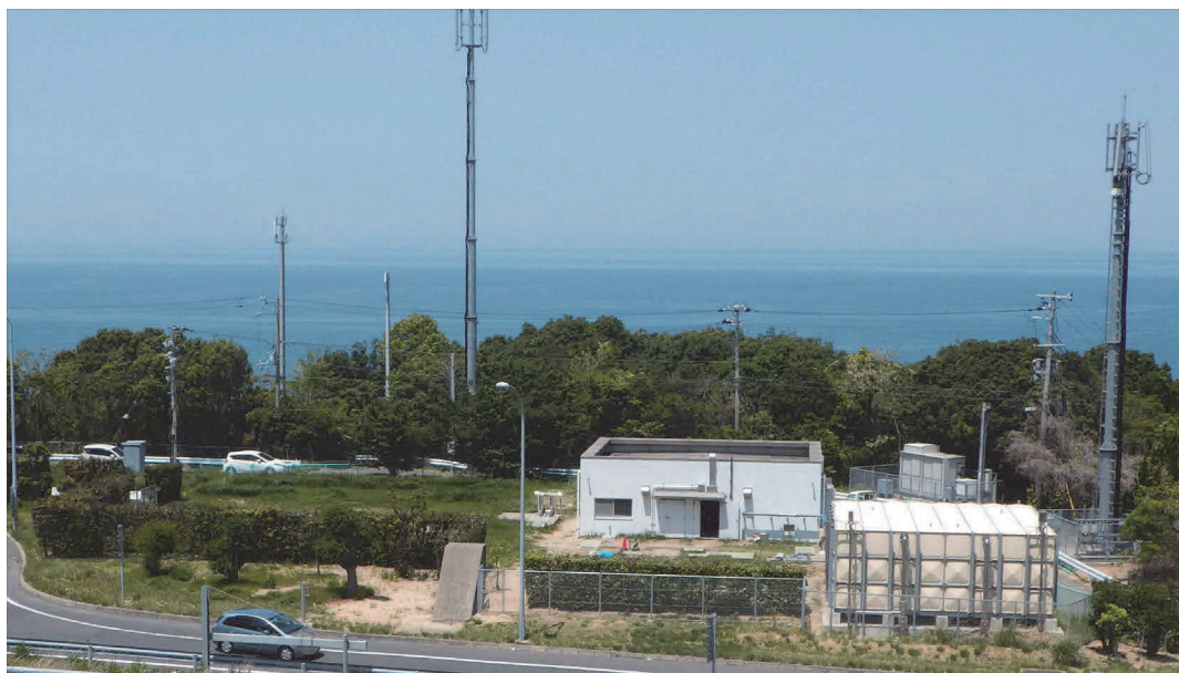
写真－3 汚水処理設備と中水貯留槽
