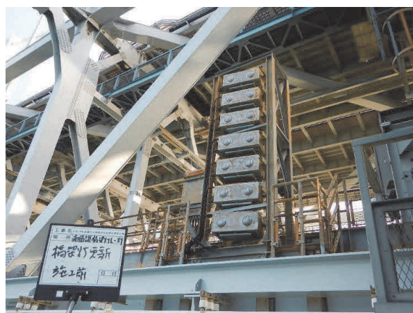
写真-2 旧橋梁灯設備（南備讃瀬戸大橋L一灯） Photo 2 Old bridge light (Minami Bisan-Seto Bridge L1)
