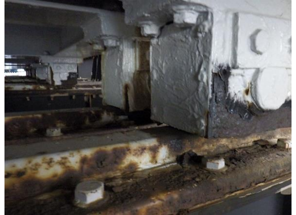
②大型伸縮装置の腐食状況
